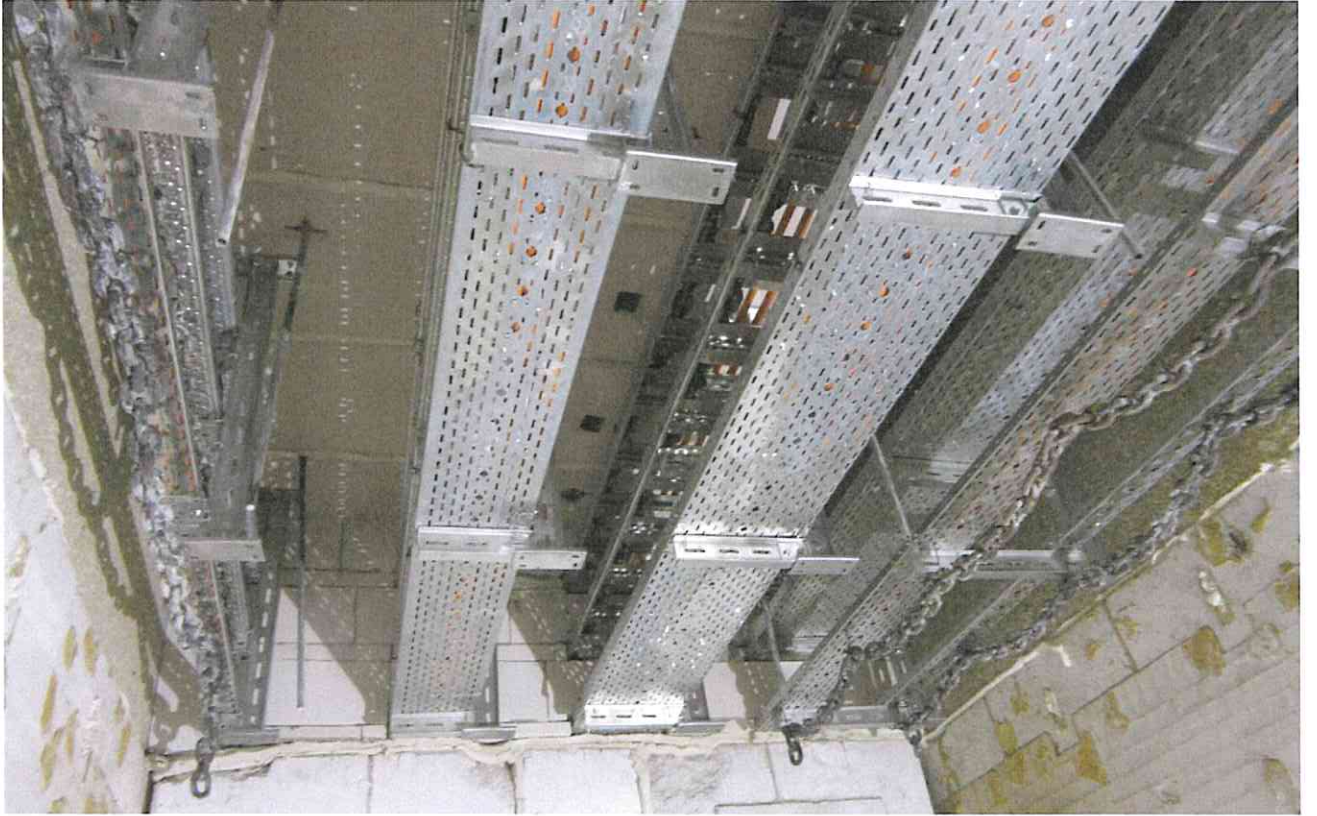
Resim B1: Kablo sisteminin test öncesi kurulumu.
